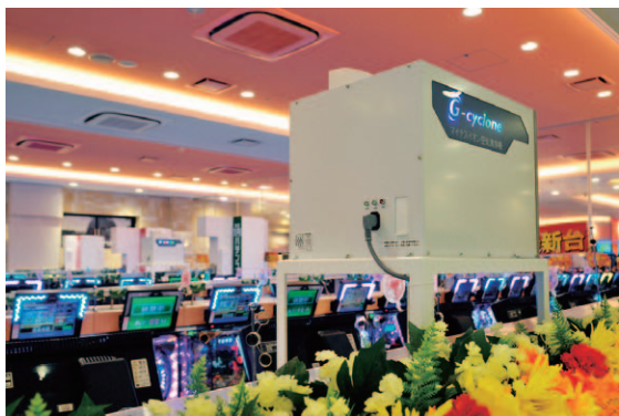
『パラッツォ千川店』は見た目の開放感も考えLow島を採用。島上の空気を攪拌する『G-cyclone』は効果的だ
